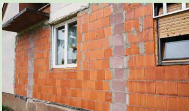
Hiša je bila zelo poškodovana. Tudi zunanje stene je bilo treba na novo zazidati.
