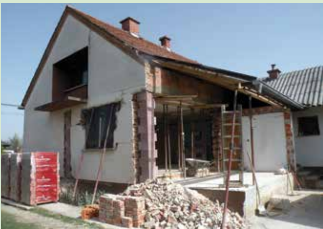
Poškodovana Korpičeva hiša.
